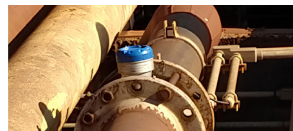
Dispositivo medidor de vazão de água residuária
