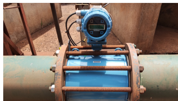
Dispositivo medidor de vazão instalado na captação em barramento
