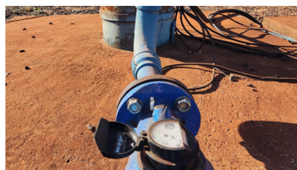
Dispositivo medidor de vazão de captação subterrânea
